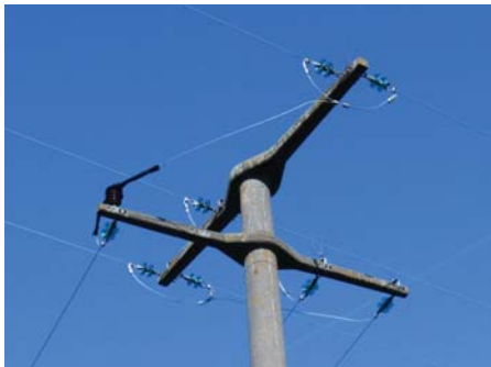
Schlecht gesicherter Strommast
